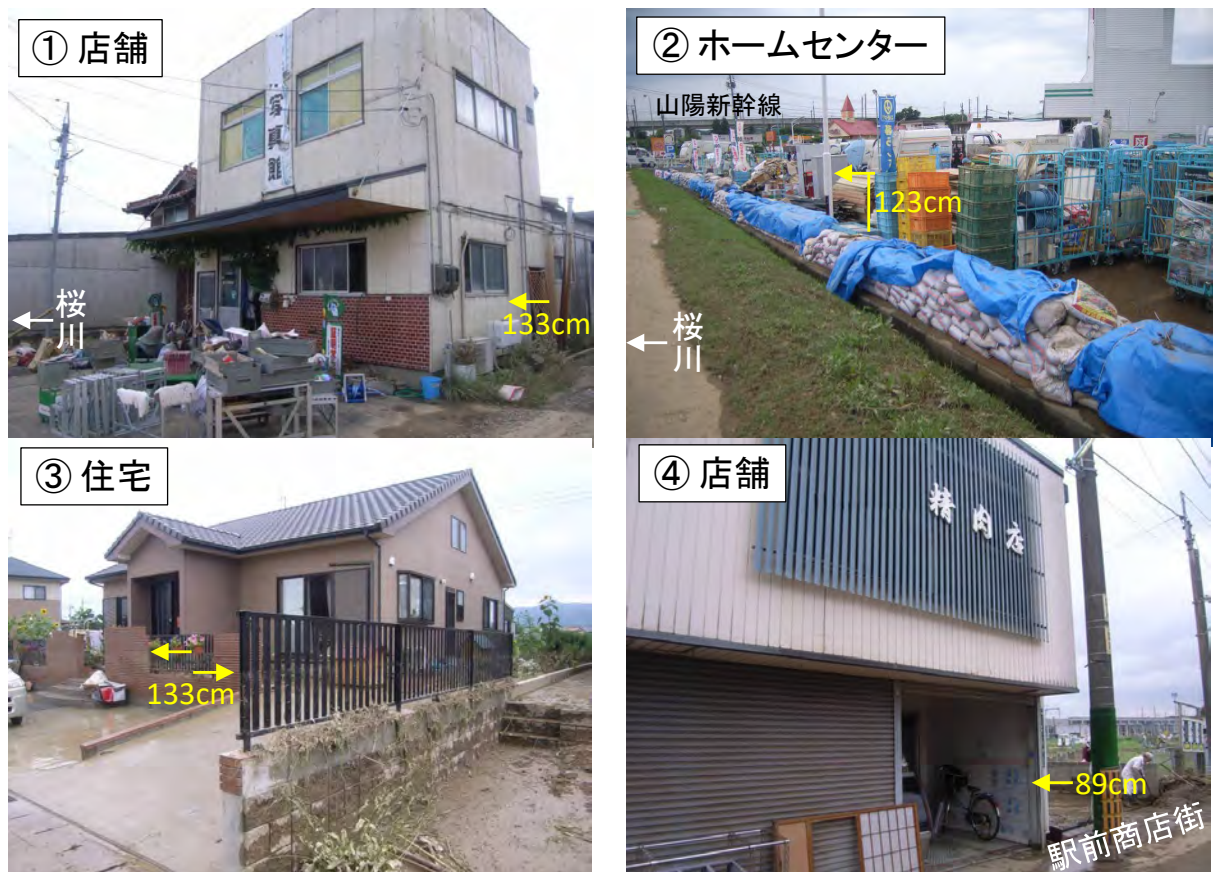
写真3 2010年水害による厚狭地区の浸水被害 (①~④の位置は図9に示す。山崎ら、2010) (浸水深 (cm) は地盤からの高さを示す)
