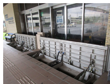
図2-5 外来入口の止水板の起動確認 (2023.7.1実施)
