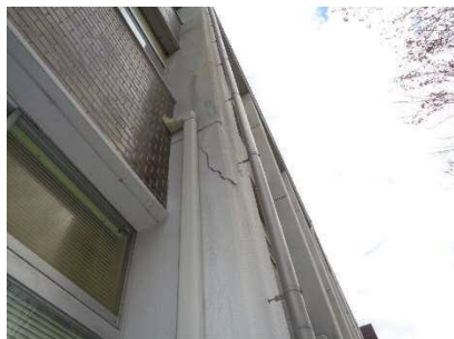
柱コンクリートの浮き
