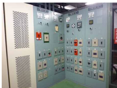
老朽化した低圧配電盤
