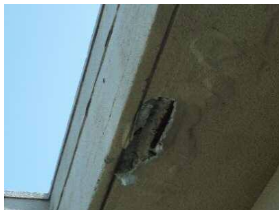
軒裏コンクリートの剥落
