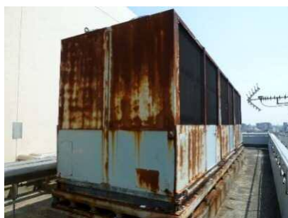
老朽化した空調設備
