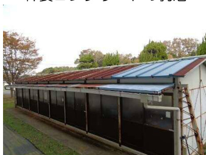
金属屋根の錆・腐食
