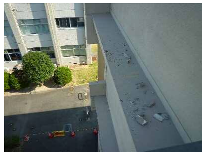
落下したコンクリート片
