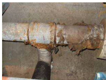
老朽化した屋外給水管
