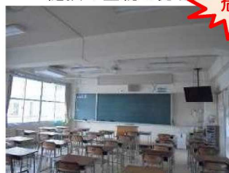
露出梁 (モルタル浮き多数)
