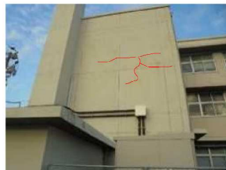
外壁の劣化、不要な煙突
