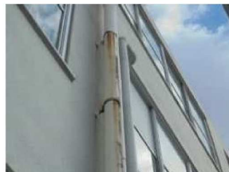
樋掴み金物の劣化
