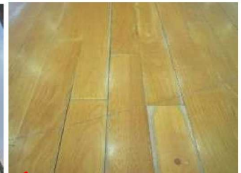
体育館床板の劣化
