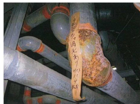
給水管の接手部分の漏水(共同構内) H28.7
