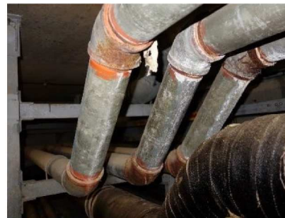
給水管の様子(共同構内)
