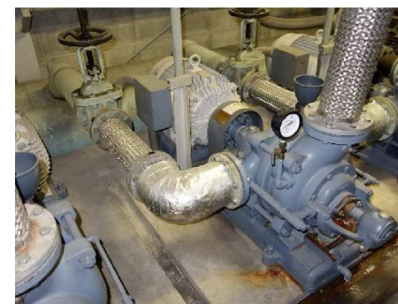
揚水ポンプ(1978年製)
