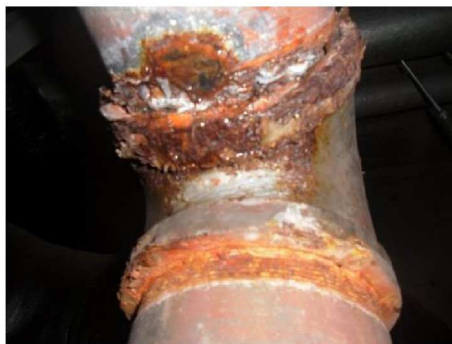
給水管の接手部分の腐食・漏水(共同構内) H28.3
