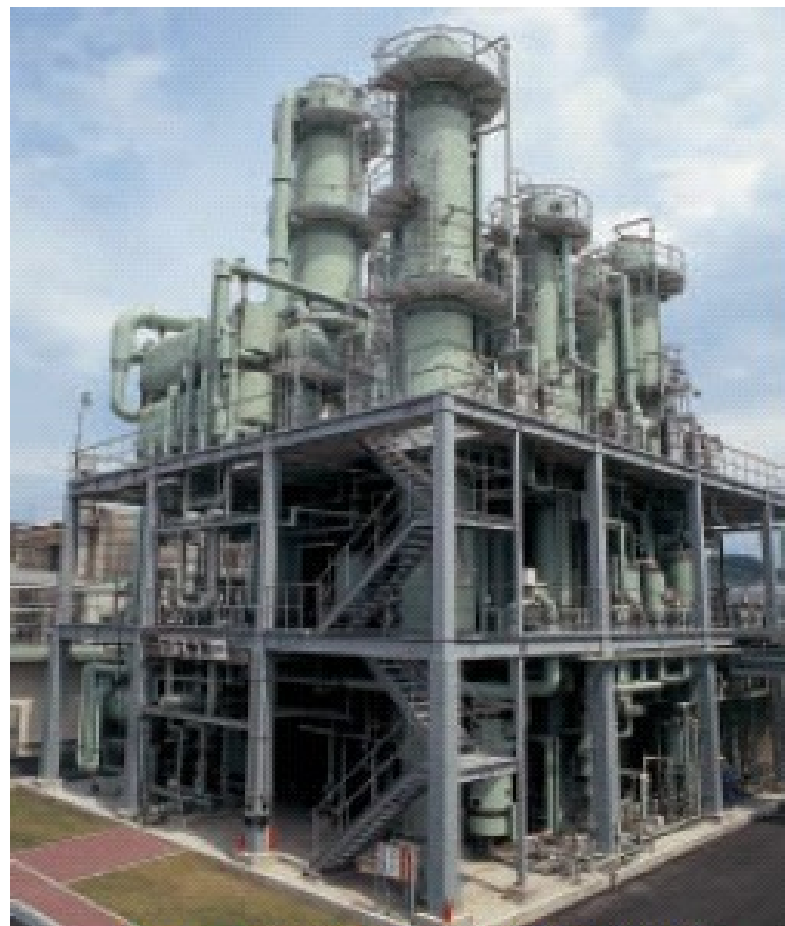
アルコール蒸留プラント(鹿児島県・出水工場)
