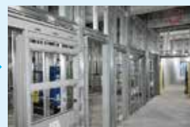
平成29年11月、新病棟2階の建物内部・外壁では、扉・窓を設置するための枠の組立工事が始まっています。
