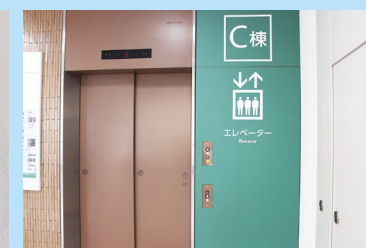
C棟エレベーター
