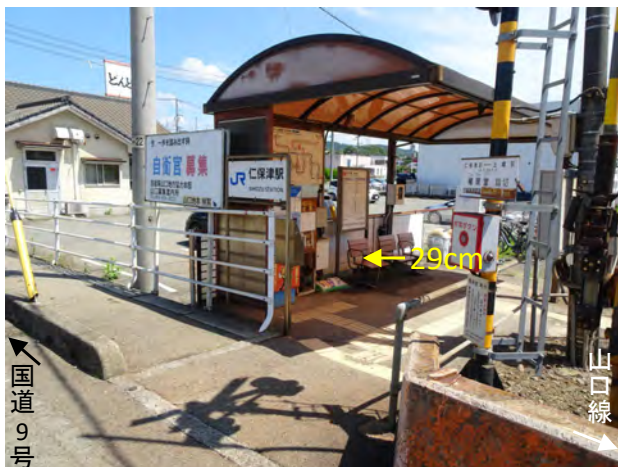
写真 4.8 仁保津駅における浸水の痕跡
