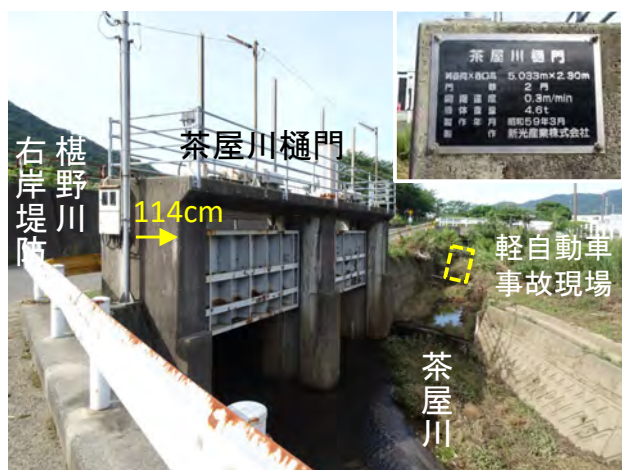
写真4.2 茶屋川樋門と軽自動車の事故現場
