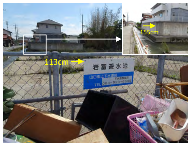
写真 2.7 岩富遊水池および周辺における浸水の痕跡（2 日撮影）
