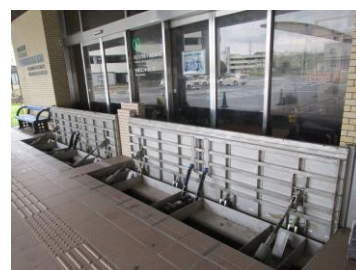
図2-5 外来入口の止水板の起動確認 (2023.7.1実施)
