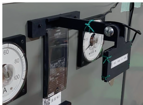
図 6-21 電力量メータと設置マイコン
